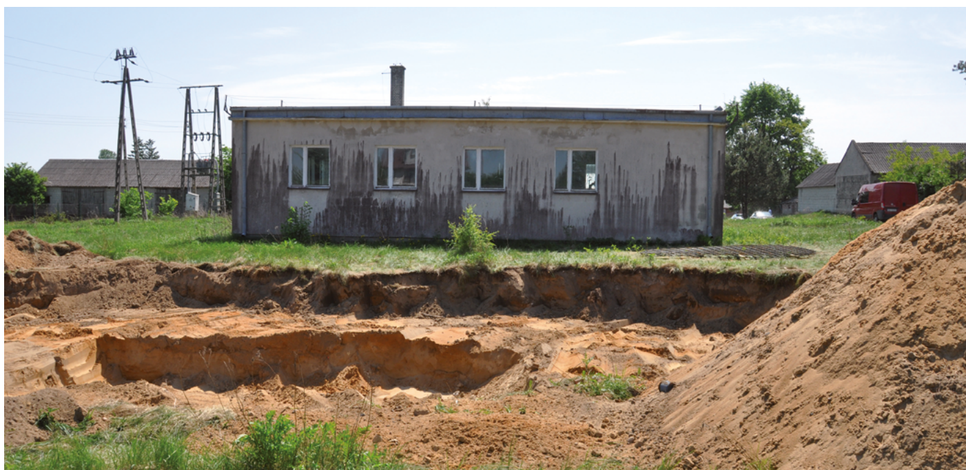
Stacja uzdatniania wody w Starych Modzelach
